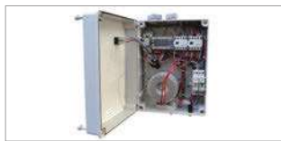
13 Cuadro eléctrico para motor cajón estanco
